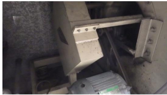
20. HOSPITAL FAN ROOM AHU-4 SUPPLY FAN
